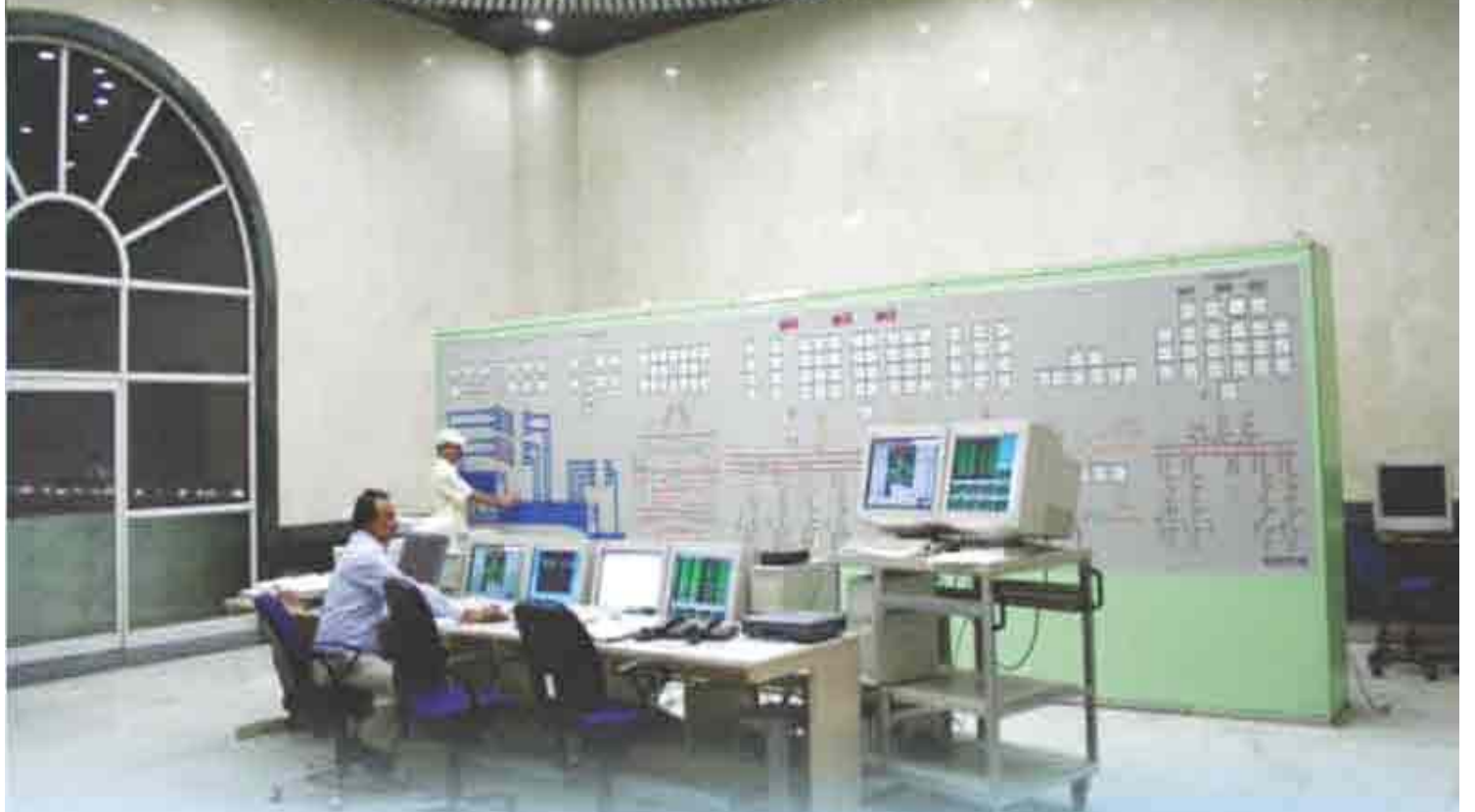
टिहरी एचपीपी के भूमिगत पावर हाउस की कंप्यूटरीकृत नियंत्रण प्रणाली Computerised Control System of Underground Power House of Tehri HPP
