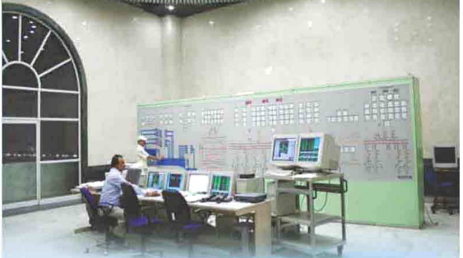
टिहरी एचपीपी के भूमिगत पावर हाउस की कंप्यूटरीकृत नियंत्रण प्रणाली Computerised Control System of Underground Power House of Tehri HPP
